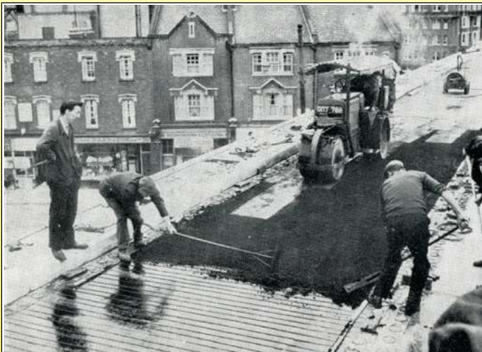
1969, Verlegung von Asphalt auf der oberen Fahrbahn einer Hammerschmidt-Kreuzung in London ( Elektrische Beheizung der Fahrbahnen, von Robert Félix, 1971, Ultimheat Museum* )
